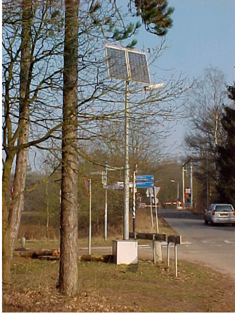
PV-verlichting kruispunt Telefoonweg en Parallelweg
